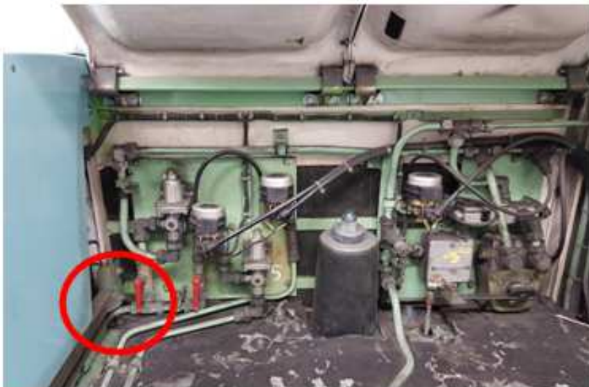
VANNE ISOL SUSPENSION VAL1 Bis coffre H1
