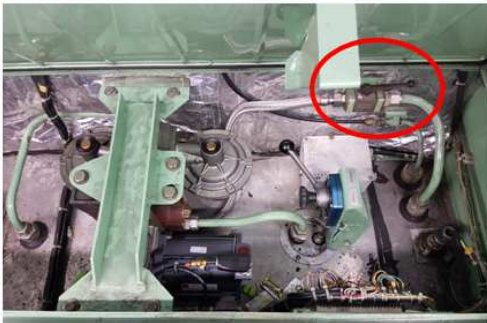
VANNE ISOL PEPPD VAL 1 ET 1 Bis coffre P3 et H6
